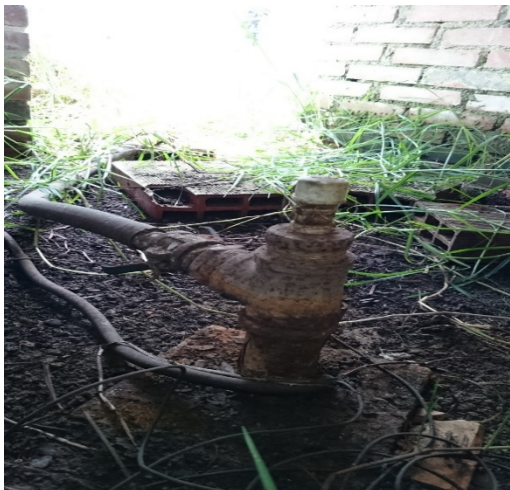
Foto 5. Tubería para toma de muestras y cable de bomba electro sumergible del pozo pz-10-0059
