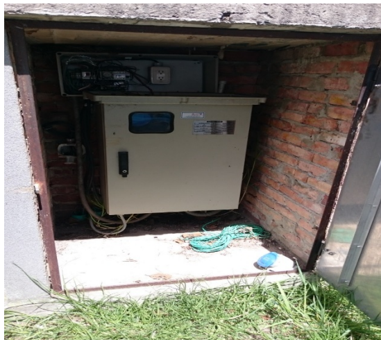
Foto 6. Panel de control eléctrico de la bomba electro sumergible del pozo pz-10-0059.
